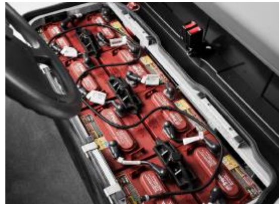
Batterie Acide Plomb
